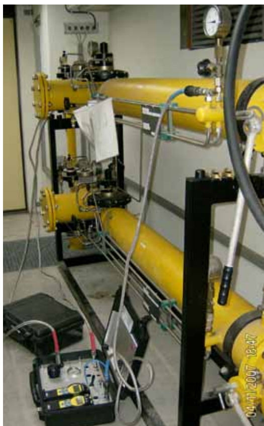
Inspectie gasstation meetkoffer
