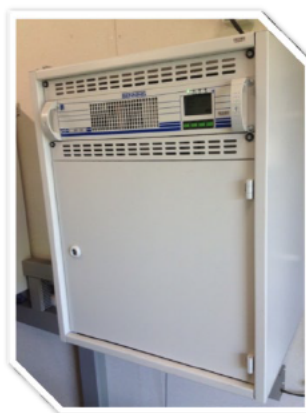
Afbeelding 16: Gleichrichterterkast t.b.v. gelijkspanningsvoorziening
