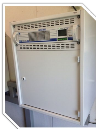
Afbeelding 16: Gleichrichterterkast t.b.v. gelijkspanningsvoorziening
